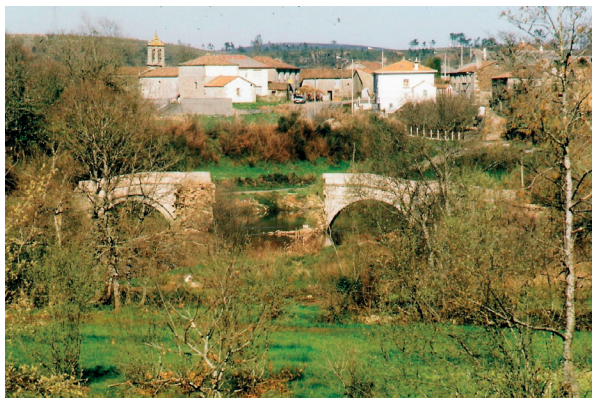
Fig. 9. Brandomil, na beira do río Xallas; estado da ponte vella tras as inundacións de 1989. Foto: Xosé M. a Lema
